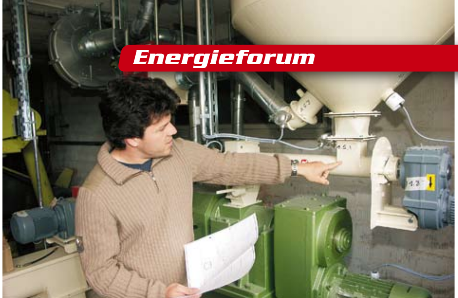
Für die Ölpresse in der Landi Suberg können zum Teil die bestehenden Anlagen neu genutzt werden. Matthias Stettler erklärt die Funktionen der einzelnen Bauteile der neu installierten Seiherschneckenpresse.
